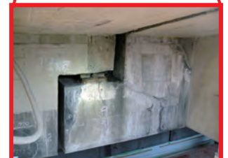
写真 3 受台損傷事例
