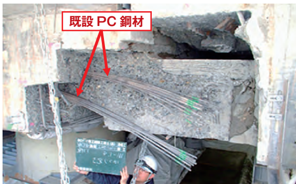
写真 14 既設 PC 鋼材露出状況
