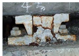
写真 2 支承損傷事例
