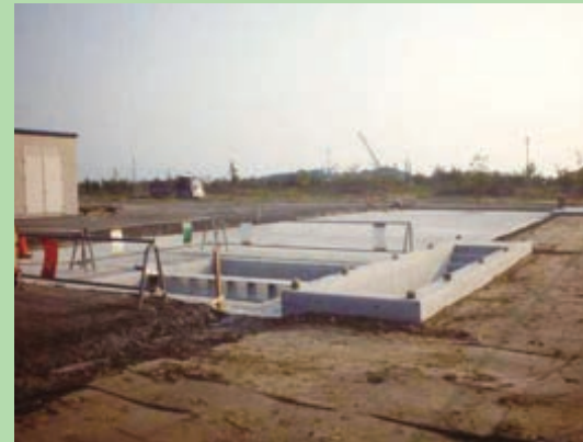
九州工場貯水槽
