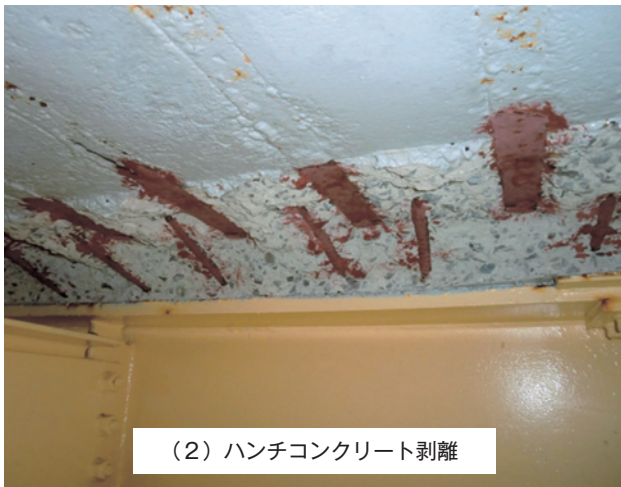
写真 3 床版下面の劣化状況
